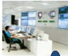
控制中心 SCADA
